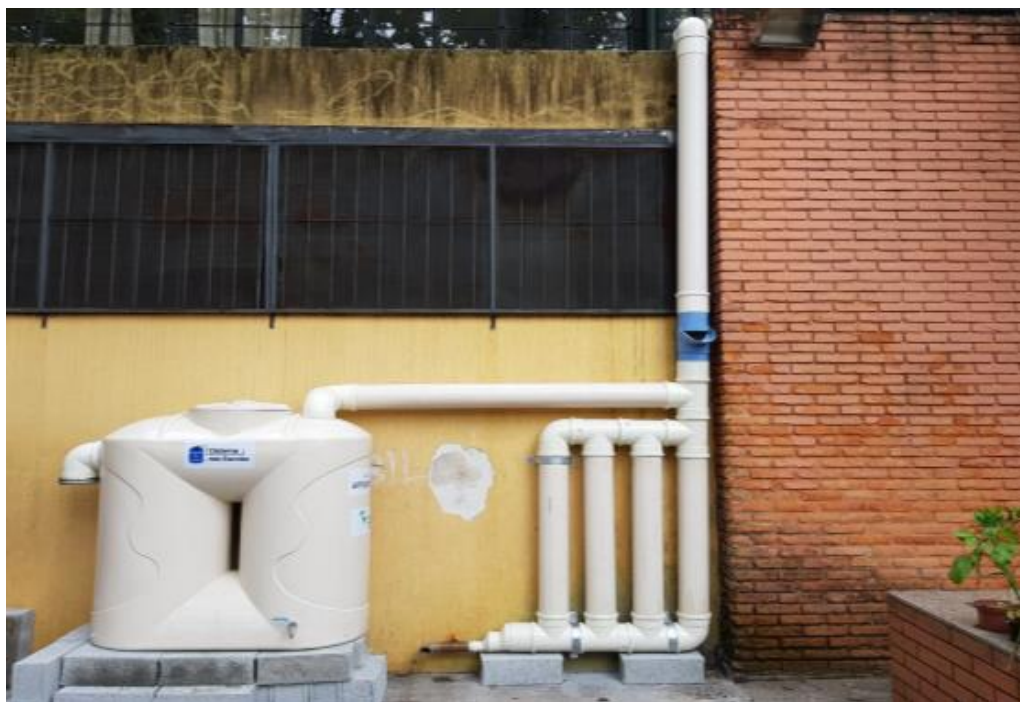
Figura 71 – Sistema de Captação de Água da Chuva Implantado pelo ESF-SP
